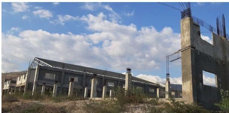
Imagem 6: Lumane Casimir: obras inacabadas. Fonte: Le Nouvelliste (2020).
